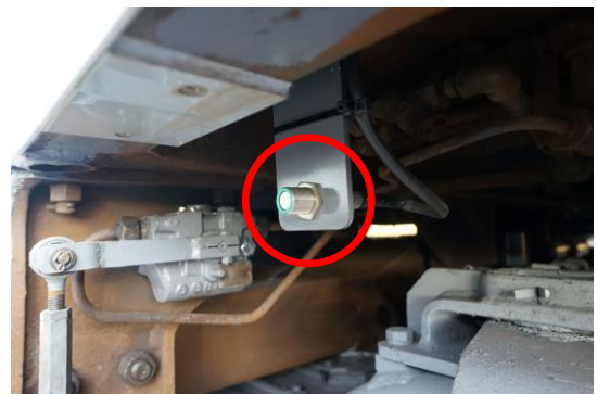
ホーム検知装置(先頭車床下)
