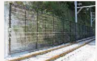
落石防護柵(叡山電車)
