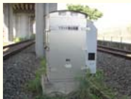
フラット検出装置
