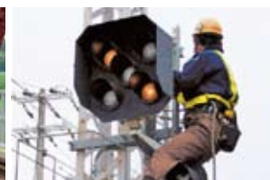
電気設備点検
