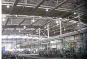
寝屋川車両工場のLED照明
