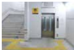
村野駅エレベーター
