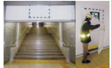
防火防煙シャッター
