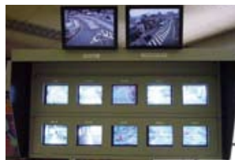
併用軌道監視装置
