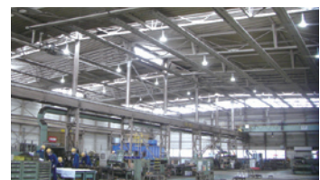
寝屋川車両工場のLED照明
