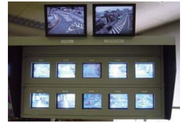
併用軌道監視装置
