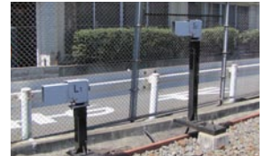
踏切障害物検知装置
