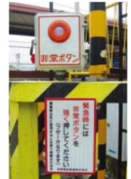
踏切支障報知装置
