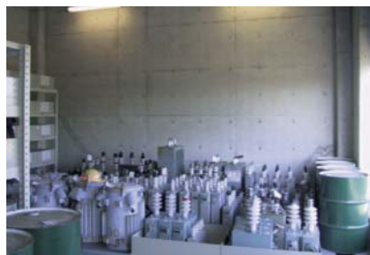
▲PCB保管庫内の廃棄物機器保管状況
