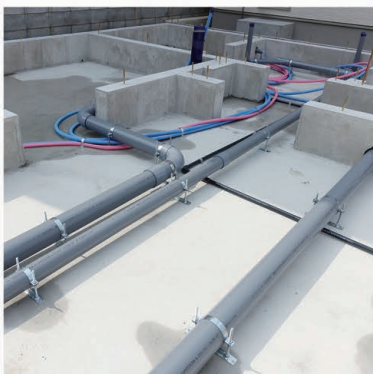
■コンクリート等に埋め込まない「露出配管」
