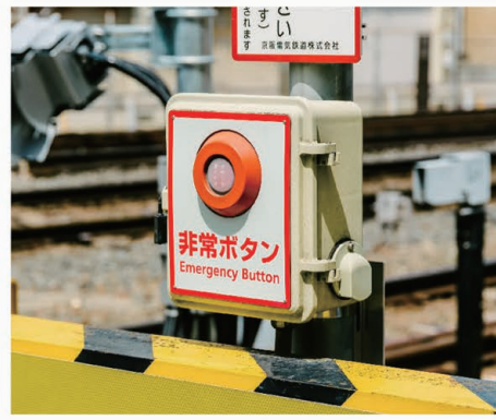
■踏切支障報知装置
