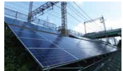
太陽光発電システム(中書島駅付近)
